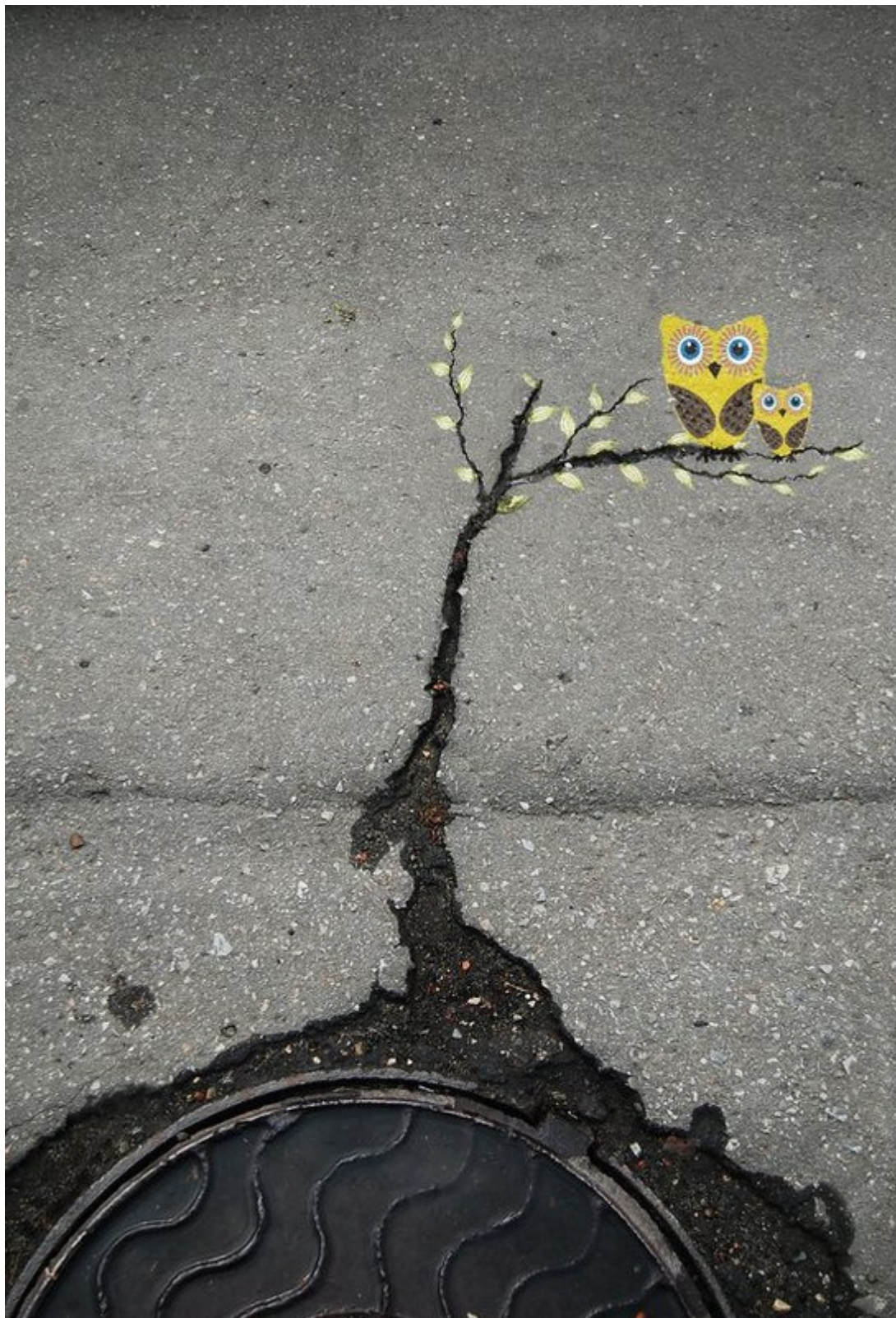
трещины , Автор: Алексей Бедный
